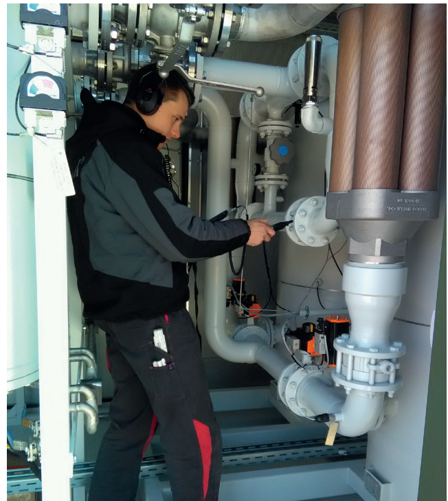
Dichtheitsprüfung durch die apikal Anlagenbau GmbH nach Abschluss der Installationsarbeiten an einer Druckluftcontainerstation Foto: apikal Anlagenbau GmbH
